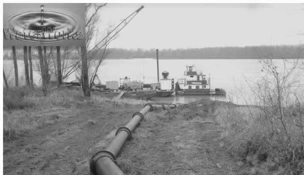
图1 密西西比河上的球墨铸铁排水压力干管
