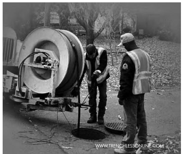
图1 管道质量检测车
