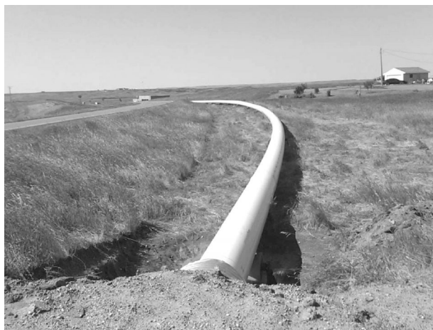
图 6 穿越公路的管柱
